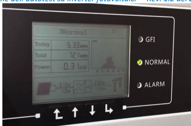
Figura 1 - Stato di normale funzionamento dell'inverter
